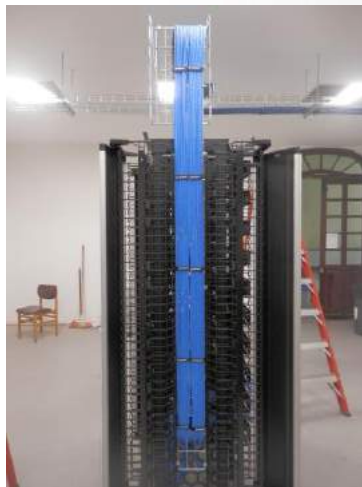
Cable UTP cat 6ª
