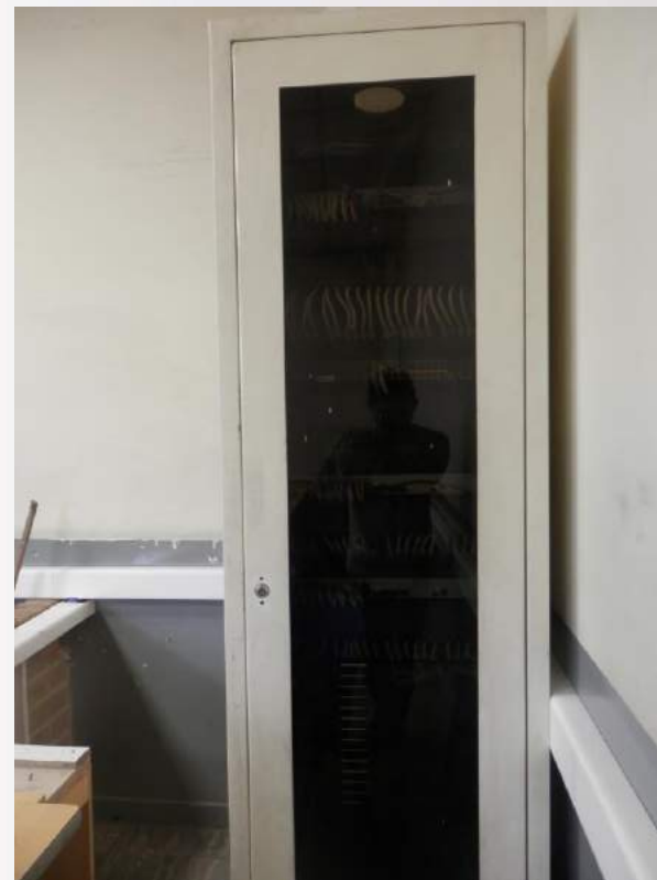
Centro de cableado sala 9
