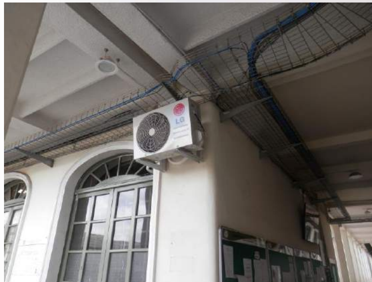
Aire acondicionado 2do piso
