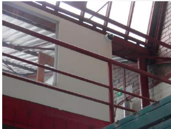
Cámara taller de motores
