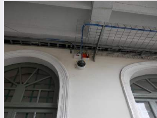
Cámara Patio B
