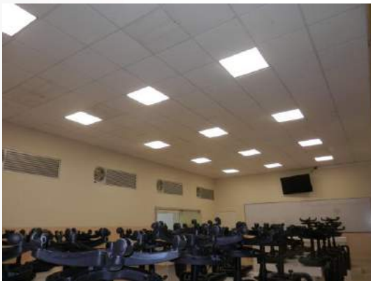
Iluminación Lab. química
