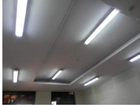
Iluminación aulas 3 er piso
