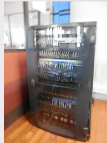
Centro de cableado
